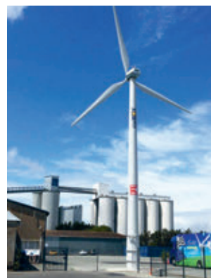
L'éolienne installée chez Ridoret devrait couvrir 10 à 20 % des besoins en électricité du siège.
