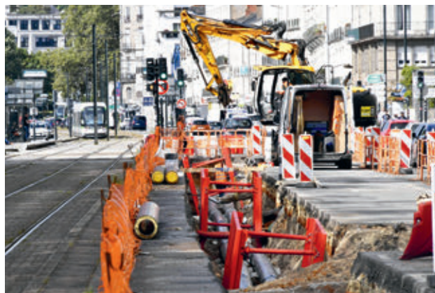
Nantes Métropole développe fortement ses réseaux de chaleur.
