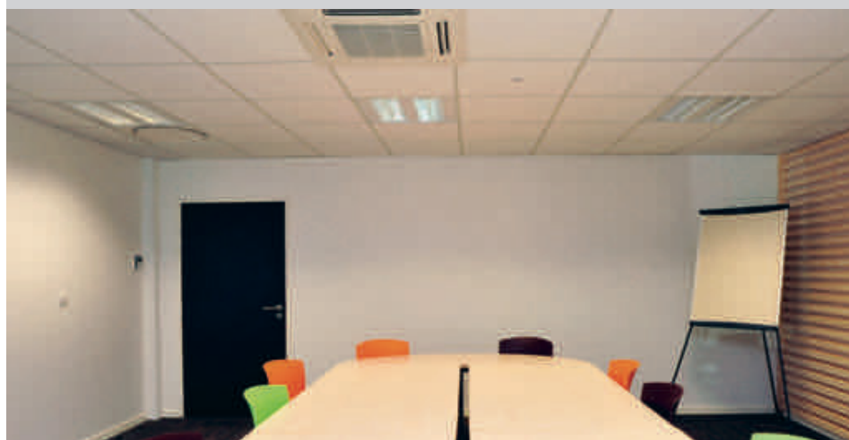
▲ Dans les salles de réunion et de visioconférence, les cassettes 4-voies 600 x 600 s'intègrent à la place d'une dalle de faux plafond.
