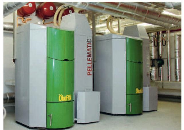
Avec des rendements proches de 95 %, les chaudières bois n'ont rien à envier au gaz ou au fioul.
