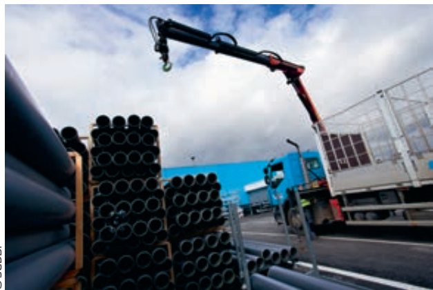
Depuis 2012, la loi impose aux collectivités de réduire les fuites sur les réseaux d'eau potable.
