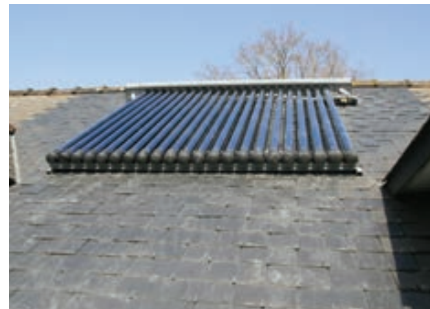
Couplé à une unité hydraulique de production d'eau chaude sanitaire, le panneau solaire à tubes sous vide assure un rendement élevé, en particulier lorsque les températures extérieures sont basses.
