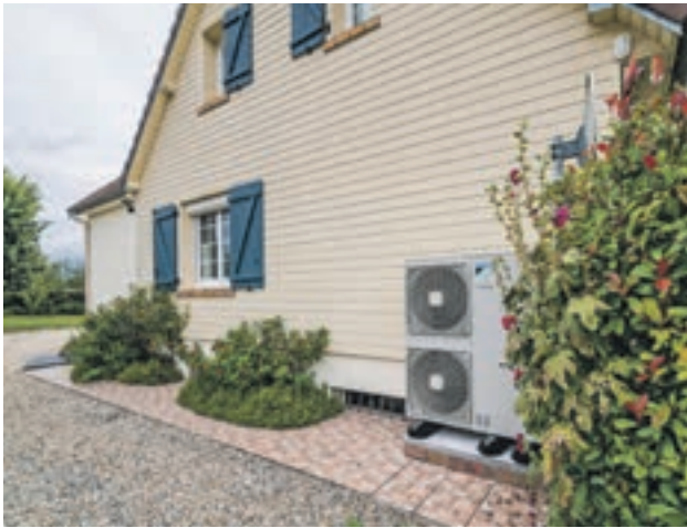
Installé sur le pignon derrière lequel se trouve le salon, le groupe extérieur ne génère aucune nuisance sonore.
