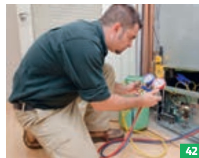
L'Apac ausculte les PAC dégradées. 42
