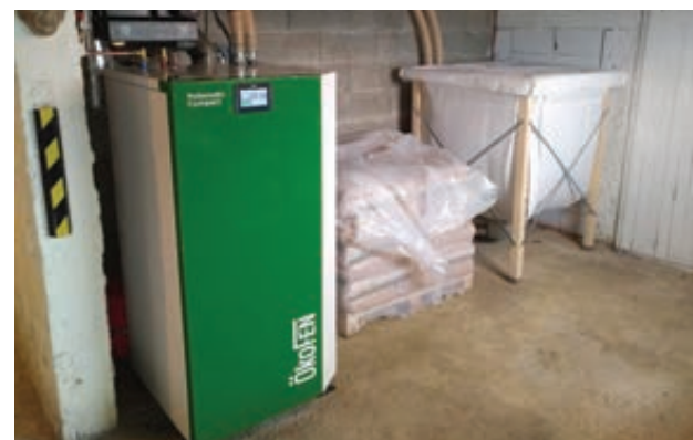
À Rovon (38), l'installation d'une chaudière à granulés Pellematic Compact avec silo, réalisée par l'installateur Massacrier Chauffage.
